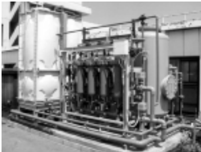
地下水膜ろ過システム装置
