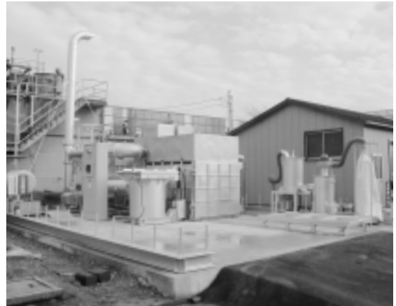
BSE対策用乾留ガス化焼却装置 / 長岡市営食肉センター
