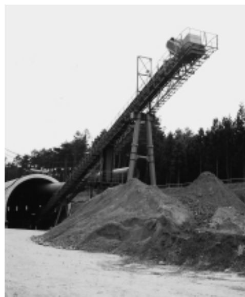
坑口部のベルトコンベヤ
