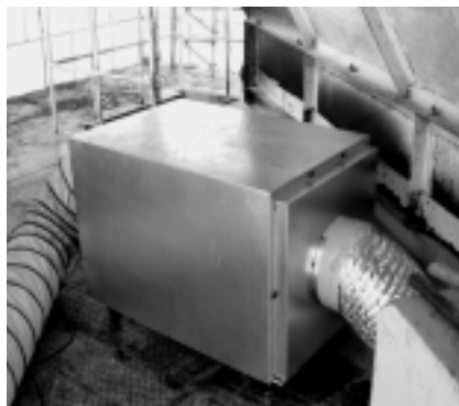
防塵装置による排気処理
